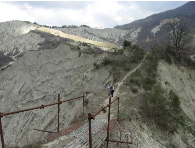
6 - il ponticello pericolante
