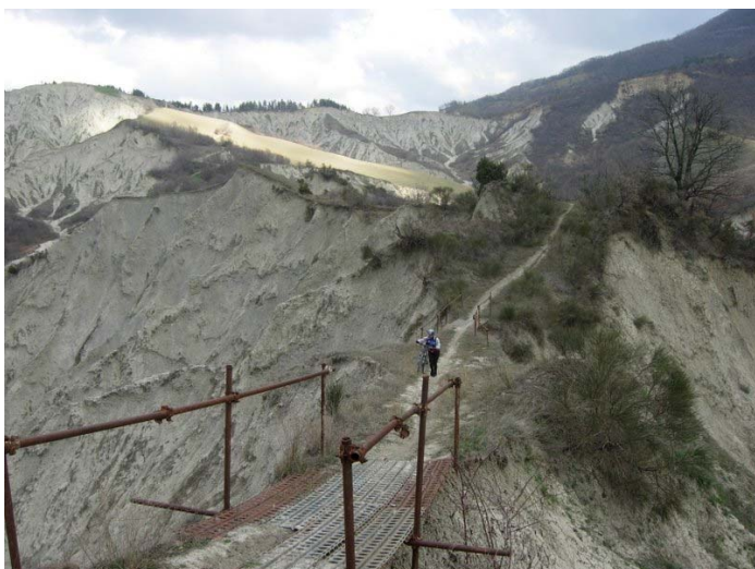
6 - il ponticello pericolante
